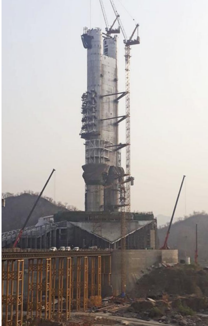
Die Statue nahm Gestalt an, indem zwei Stahlbeton-Zylinder von einem Stahlskelett umgeben wurden. Daran haben die Statuen-Bauer 8 Millimeter starke Bronzeplatten angebracht. Zum sicheren Halt der Konstruktion tragen zahlreiche Befestigungs- und Installationssysteme von Fischer bei.
